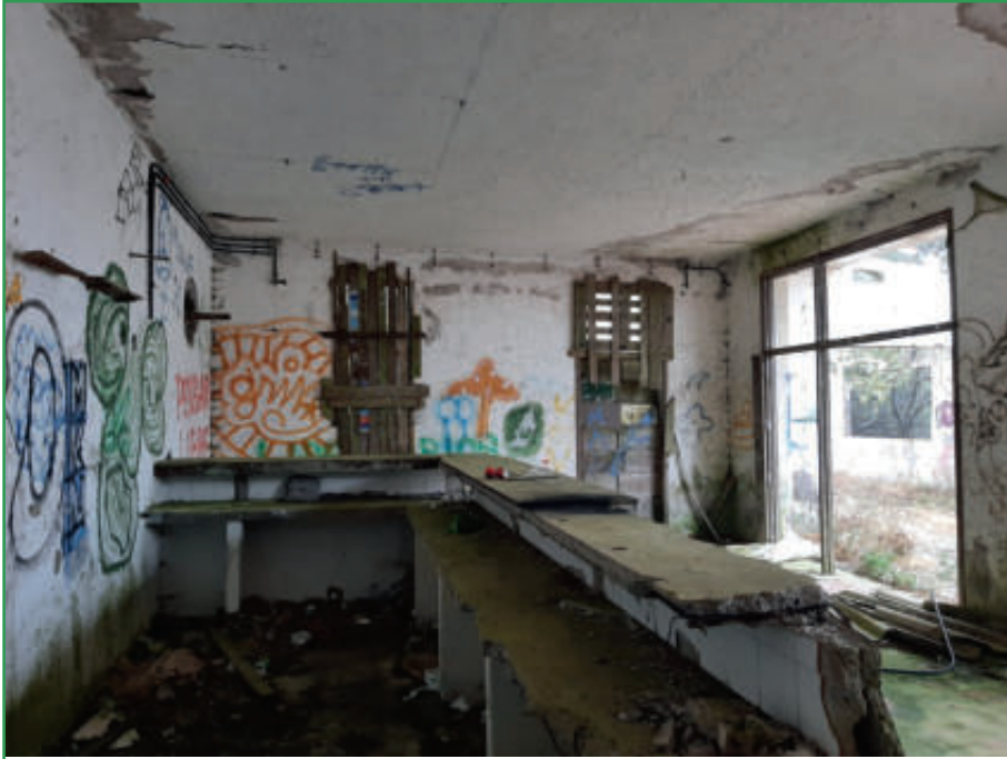
Das alte Gemäuer ist einsturzgefährdet und gefährlich für Neugierige, die es betreten.
