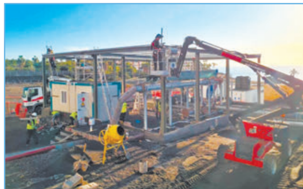
Mobile Kläranlagen haben sich schon auf El Hierro und La Palma bewährt (Foto/GobEsp)
