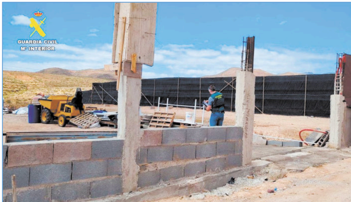
Illegale Bauten schossen wie Pilze aus dem Boden (Foto/GuardiaCivil)
