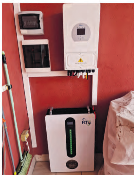
Unabhängigkeit dank Speicheranlage (Foto/PhotovoltaikTeneriffa)
